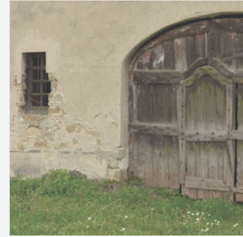
Alte Holzelemente. Undichte Raumabschlüsse.
