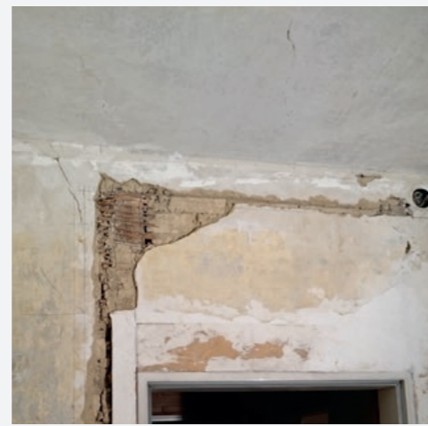
Diverse Verputze. Fehlstellen.
